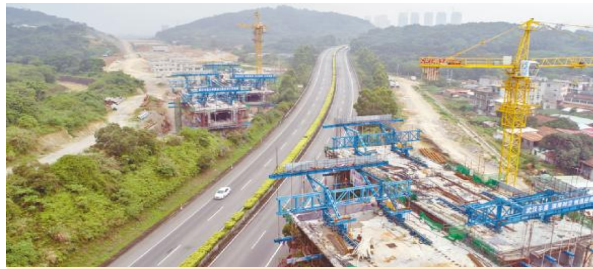
作为木兰大道一期的控制性工程,上跨莆秀高速公路的大桥眼下正加紧建设,采用悬臂浇筑法施工。图为6月8日该项目施工现场。本报记者 蔡昊 摄
