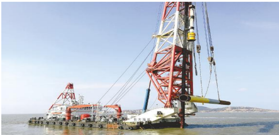
岁末年初，秀屿区立足高质量发展落实赶超，抢时间、鼓干劲，开足马力加快推进项目建设，奋力冲刺第一季度“开门红”。图为1月11日省重点项目三川海上风电有限公司平海湾海上风电场F区项目海上沉桩作业现场。 吴志军 郑启团 摄
